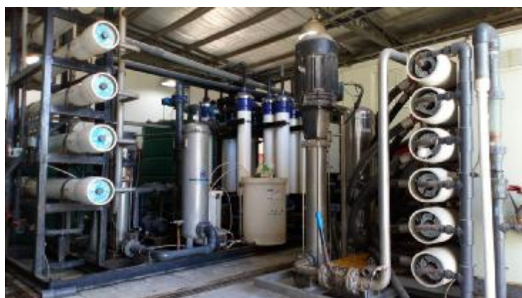
Planta filtración + Módulo adicional
