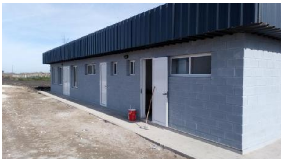
Sector servicios Recuperadores
